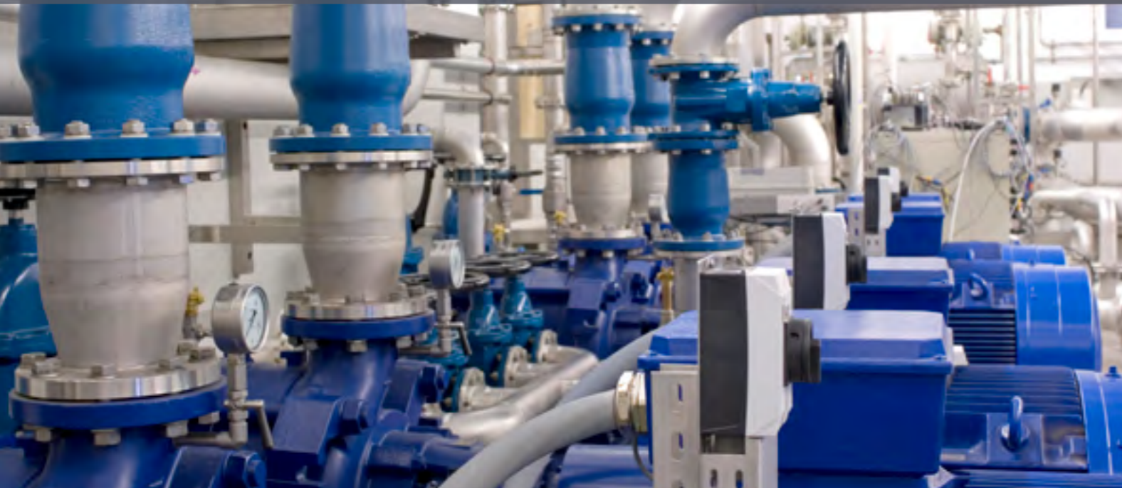
Pumpen, Lüfter und Förderbänder
